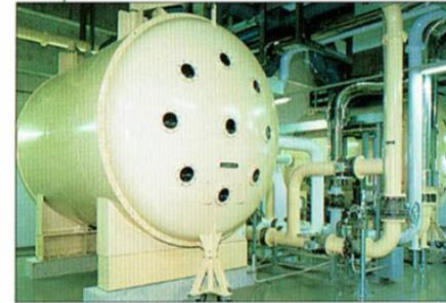
1998年：電力・産業システム事業所 当社オゾン設備による大阪府村野浄水場平面系高度浄水処理施設(125万トン/日(国内最大級))が稼動
